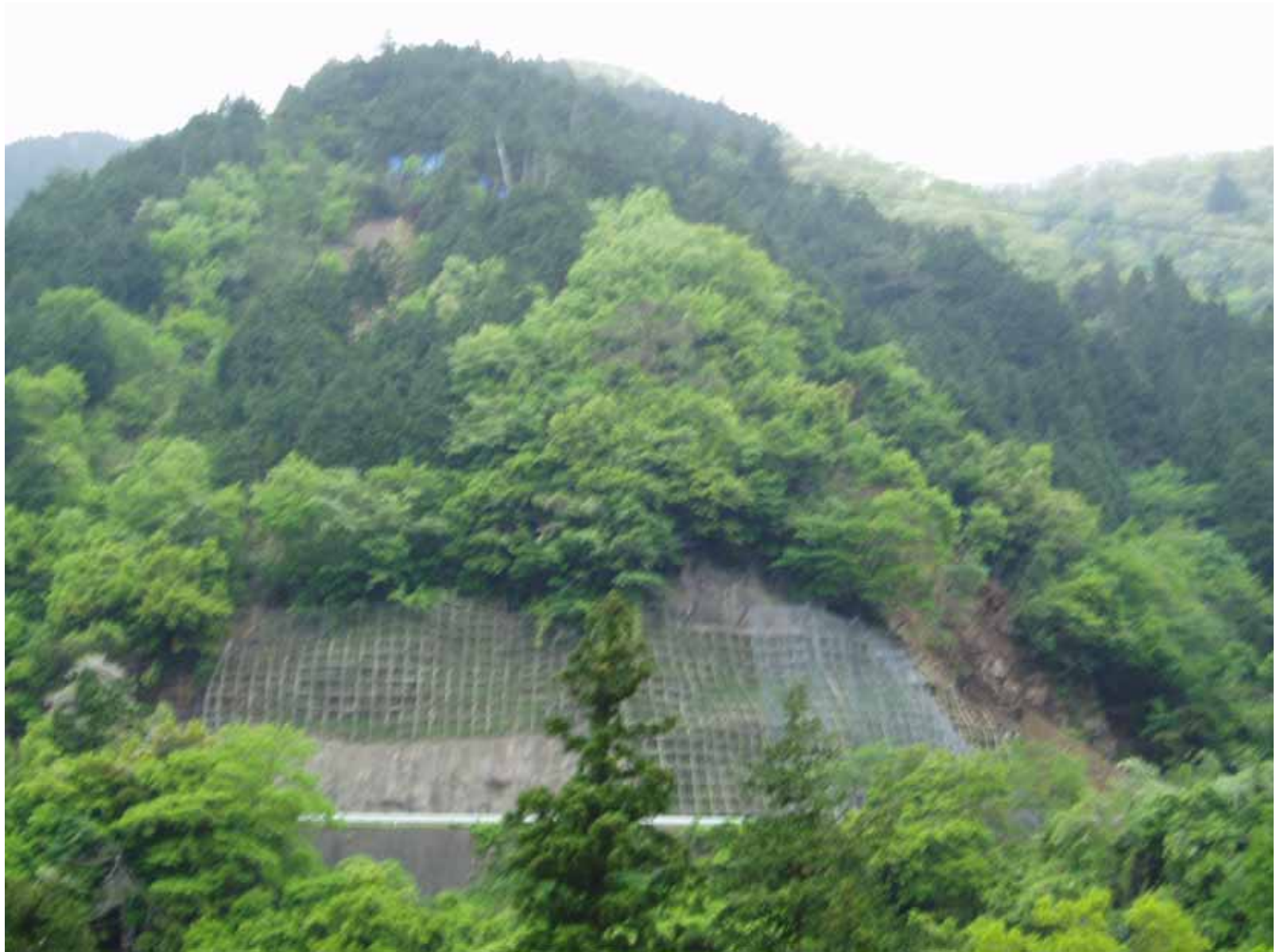
地すべりブロック端部での崩落
