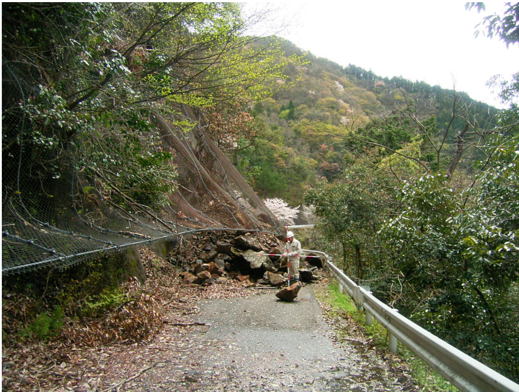
崩壊現場下部
