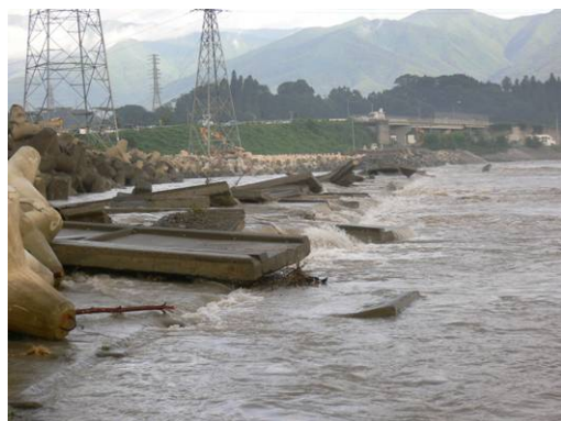
④護岸被災状況
