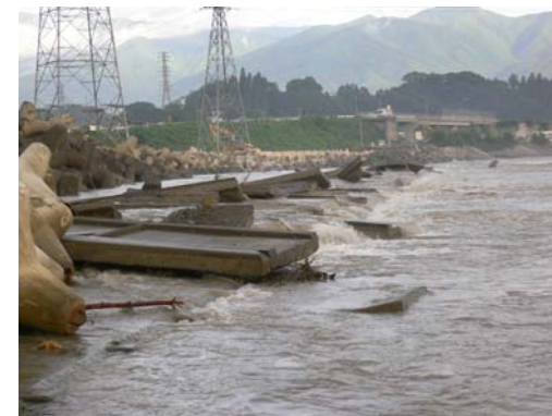
③護岸被災状況
