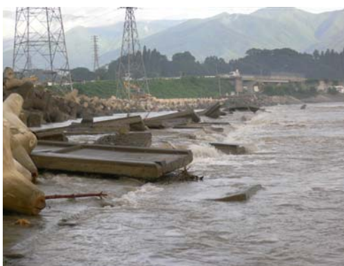
⑤護岸被災状況
