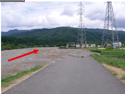
①7/19 堤防決壊直後(上流側から)
