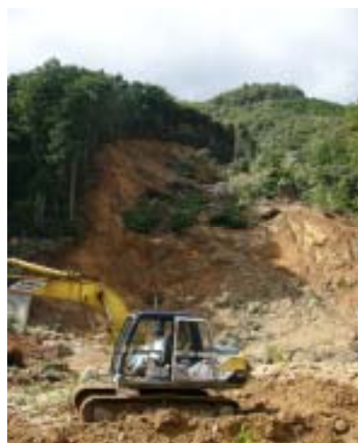
崩壊頭部の状況
