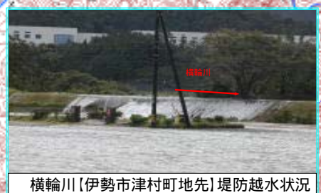
横輪川【伊勢市津村町地先】堤防越水状況
