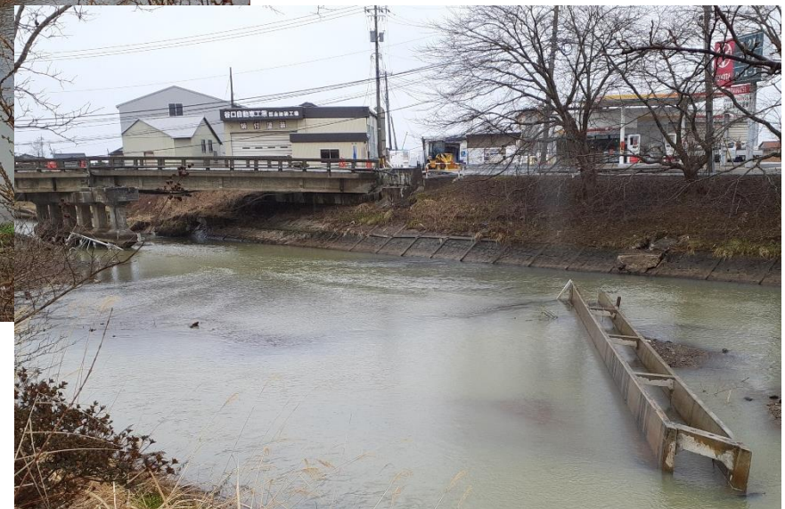
橋側歩道橋の落下した橋桁(上流側)
