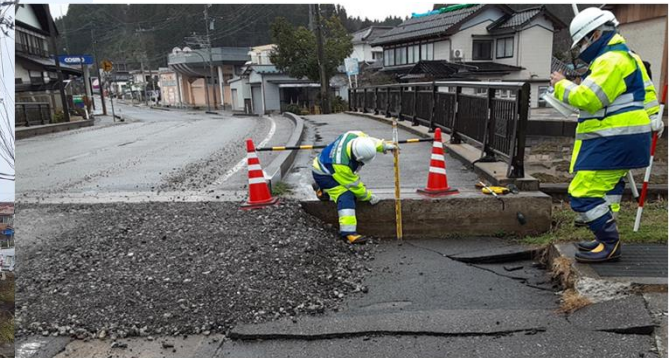
橋台背面が沈下 (40cmの段差)
