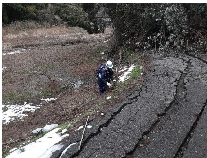
斜面崩落による道路途絶
