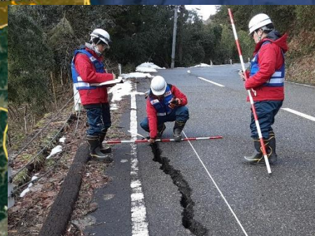
被災状況調査班：道路班 能登町内にて現地調査
