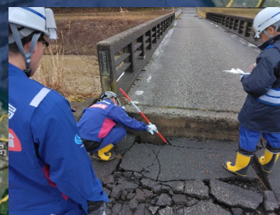
被災状況調査班 道路班 珠州市における現地調査
