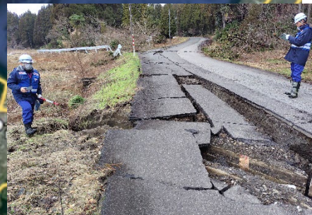
被災状況調査班 道路班 珠洲市における現地調査
