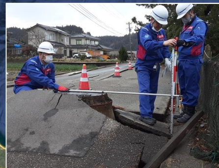
被災状況調査班 道路班 七尾市鶴浦町
