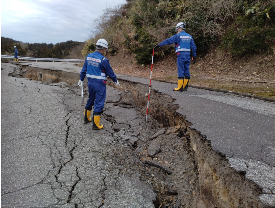
珠洲市内にて現地調査【道路班】
