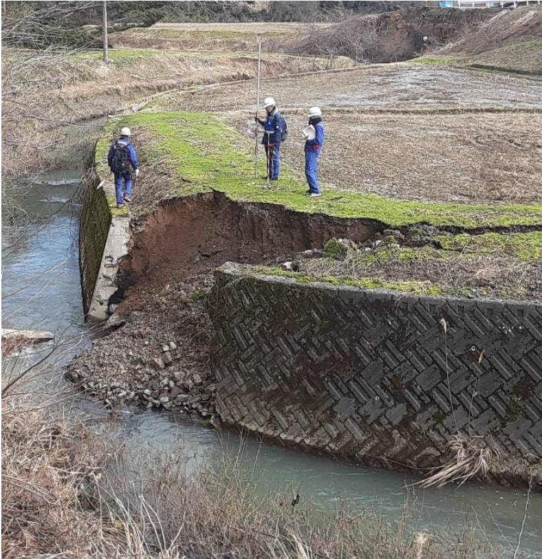
珠洲市(大谷川)の現地調査【河川班】
