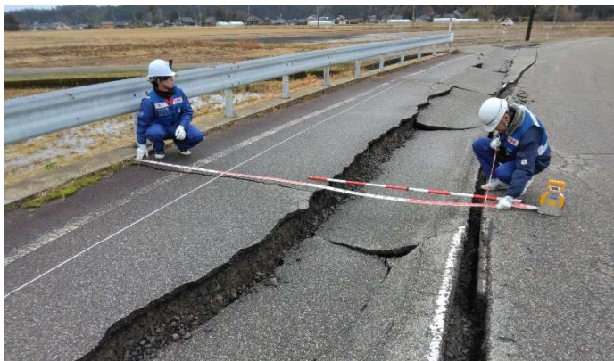
○珠洲市における被害状況調査【道路班】
