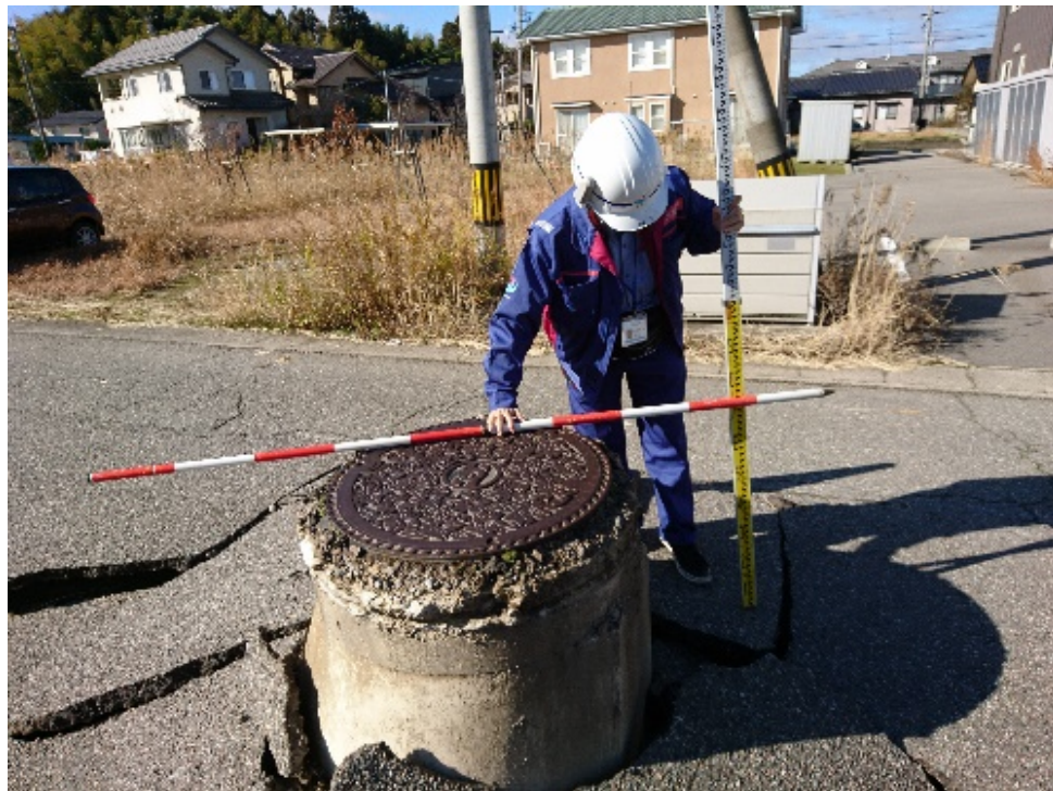
水道支援班による和倉温泉地区 (七尾市)での被害状況調査
