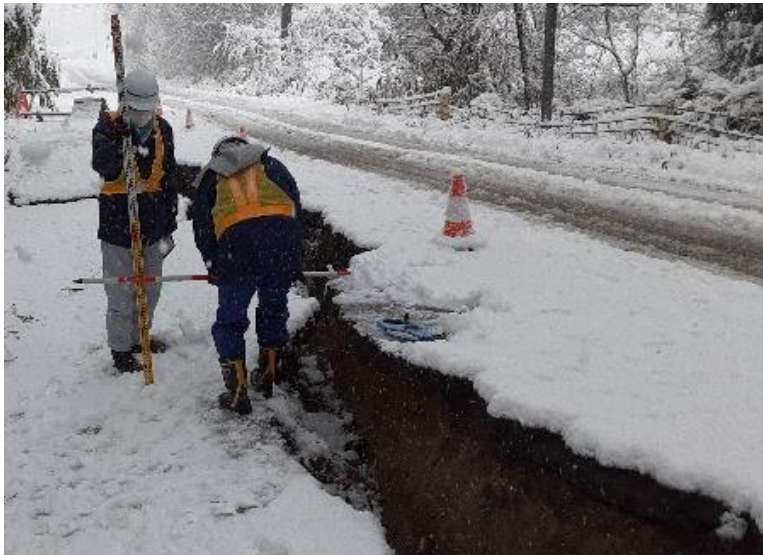
○道路班による被害状況調査 (七尾市内)
