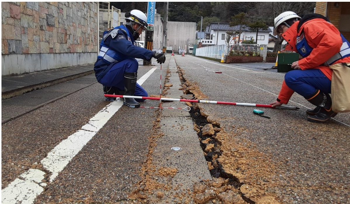
能登町内にて被災状況調査【道路班】
