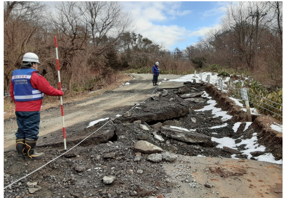
能登町内の現地調査【道路班】
