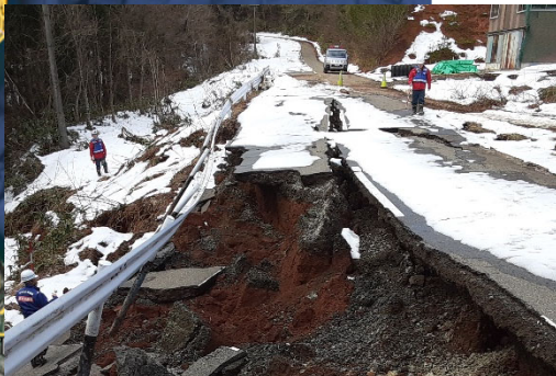
被災状況調査班:道路班 能登町内にて現地調査
