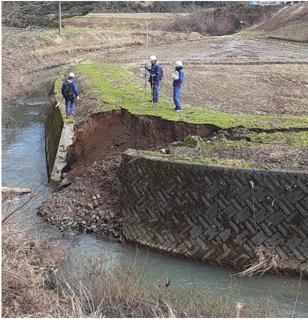
珠洲市(大谷川)の現地調査【河川班】
