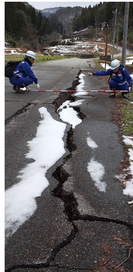
珠洲市にて被災状況調査【道路班】
