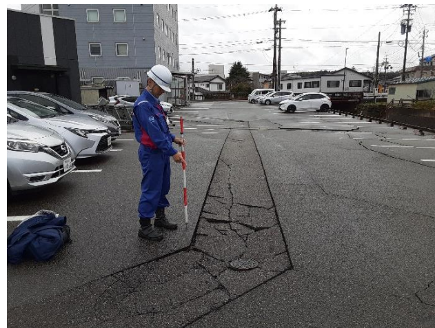
七尾市にて名古屋市水道局との被災状況調査【水道支援班】
