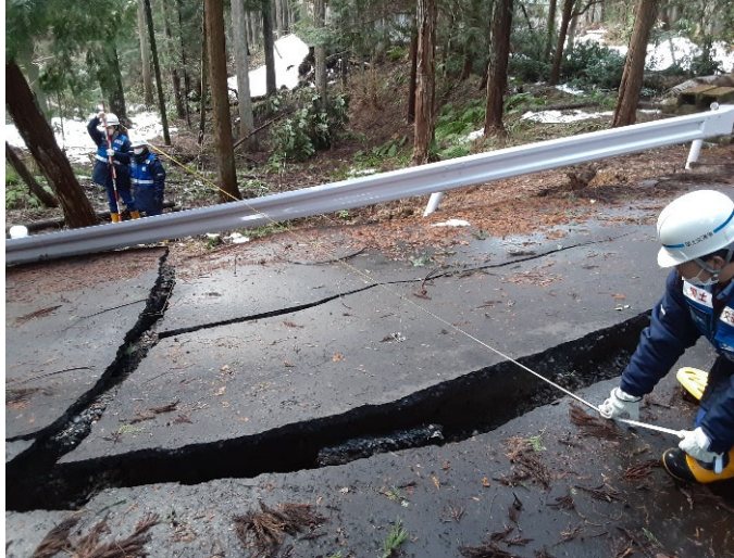
珠洲市内被災状況調査【道路班】
