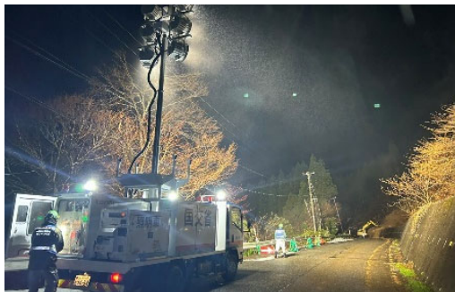
輪島市における照明車支援【照明支援班】
