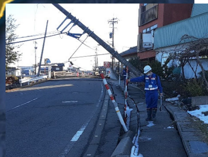
被災状況調査班 道路班 珠洲市における調査
