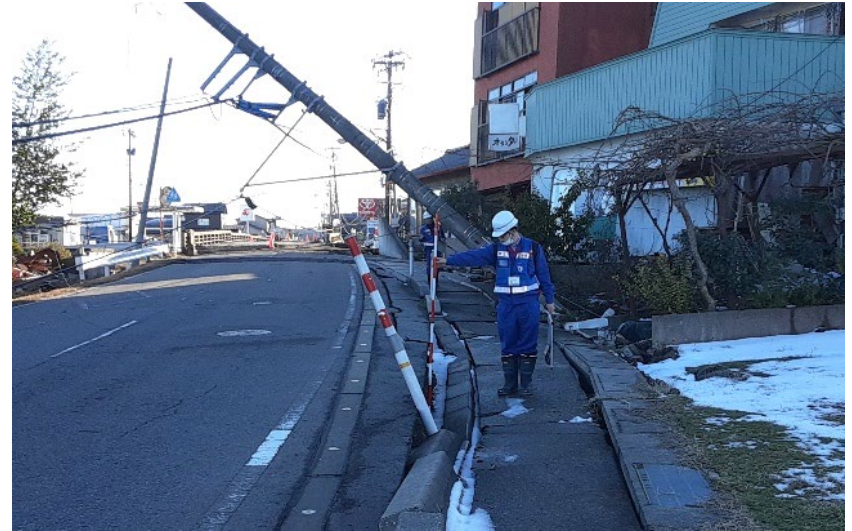
珠洲市における被害状況調査【道路班】
