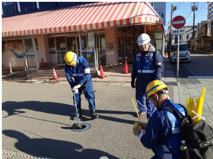
七尾市における名古屋市水道局と被災状況調査【水道支援班】
