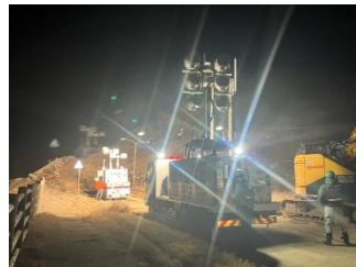
輪島市における照明車支援【照明支援班】
