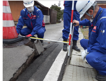
道路班による七尾市における被害状況調査
