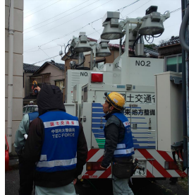
電源支援班による照明車から避難所への電源供給
