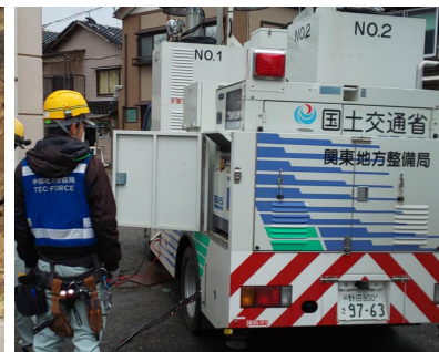
電源支援班による照明車から避難所への電源供給
