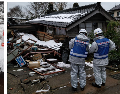
建築班による珠洲市における危険度判定調査
