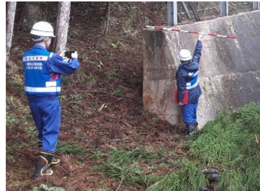
砂防班による石川県輪島市における被害状況調査(上記写真)
