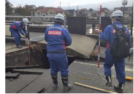
道路班による石川県七尾市における被害状況調査
