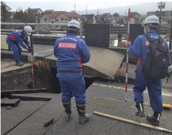
道路班による石川県七尾市における被害状況調査
