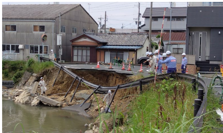
山中川の被災状況調査
