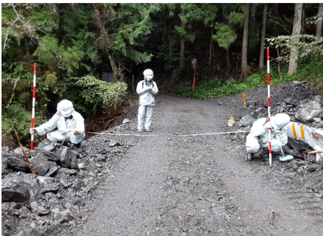
【被災状況調査(川根本町)】
