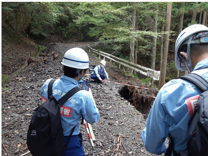
【被災状況調査(川根本町 文沢)】
