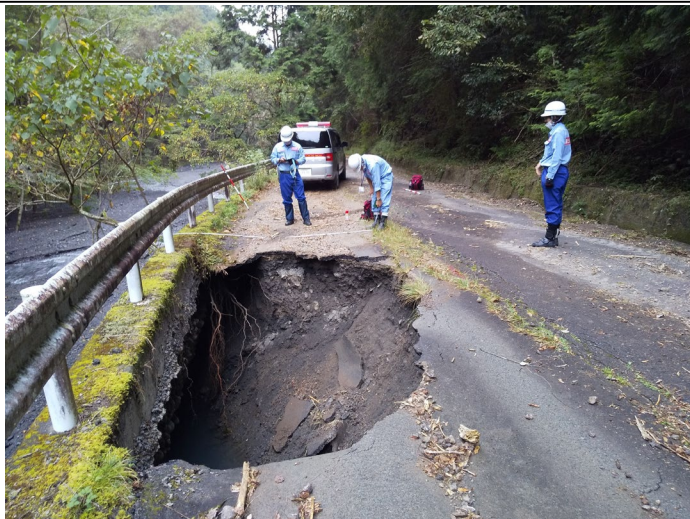
【被災状況調査(川根本町 東藤川)】
