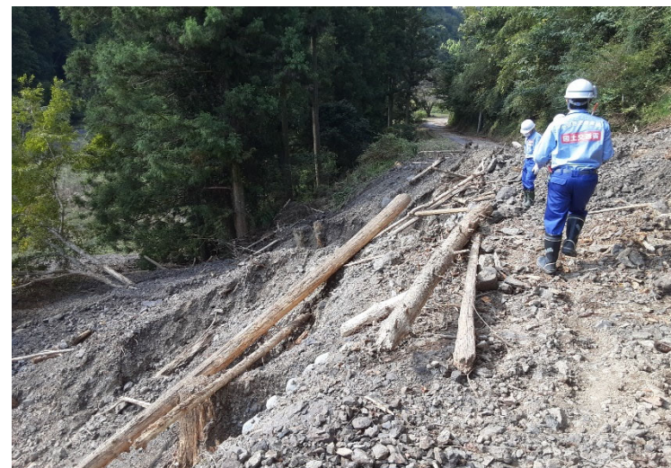
【被災状況調査(川根本町 下長尾)】
