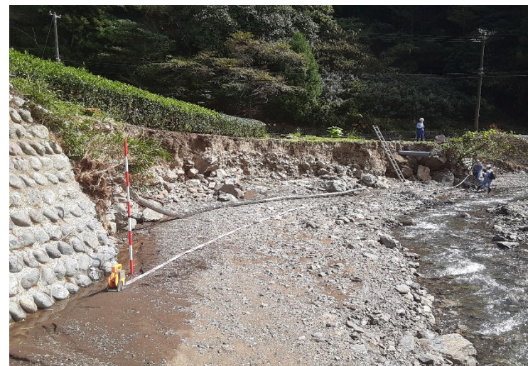
【被災状況調査 (島田市川根町 上河内)】
