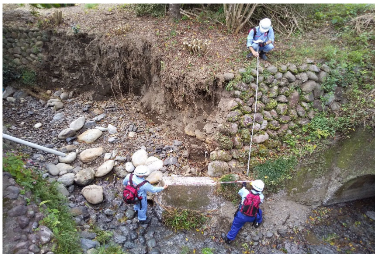
【被災状況調査(川根本町 田野口)】
