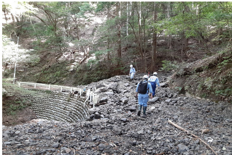
【被災状況調査(島田市川根町 家山)】
