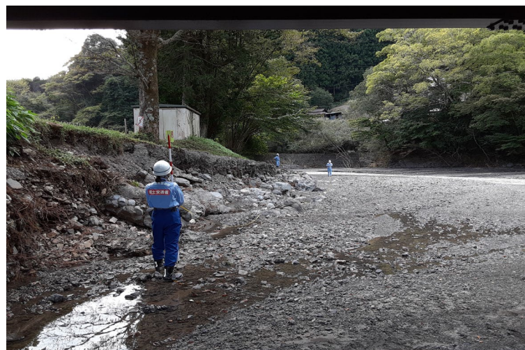
【被災状況調査(島田市川根町 笹間上)】
