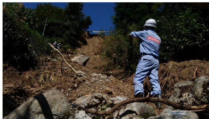
【被災状況調査(川根本町)】
