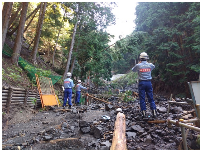
【被災状況調査(川根本町)】
