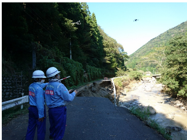
【被災状況調査(島田市)】
