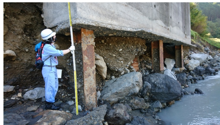
【被災状況調査(川根本町)】
