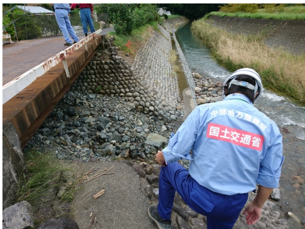
【被災状況調査(島田市)】
