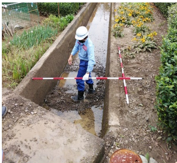
【被災状況調査(島田市)】
