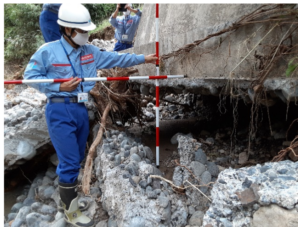
【被災状況調査(島田市)】
