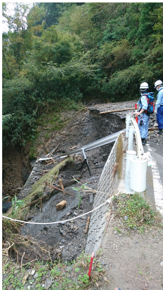
【被災状況調査(川根本町)】
