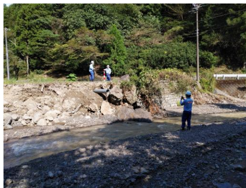
【被災状況調査(島田市)】
