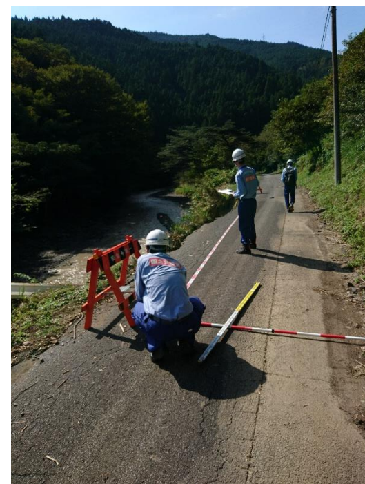
【被災状況調査(川根本町)】
