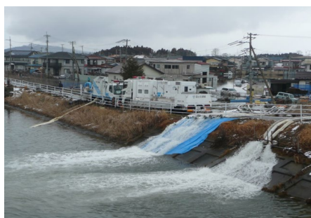
【排水ポンプ車】
