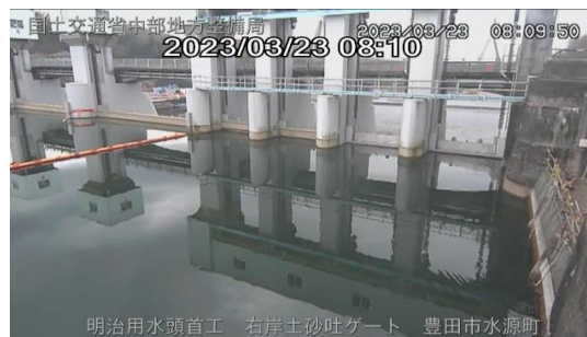
明治用水頭首工 右岸土砂吐ゲート 豊田市水源町
