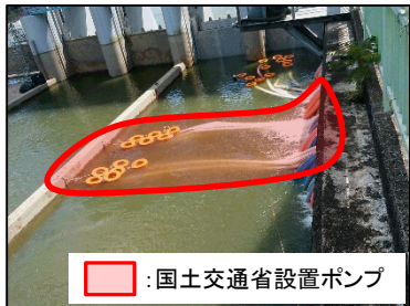
排水ポンプ車② (ポンプ12台)稼働中
