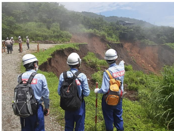
被災箇所の調査
