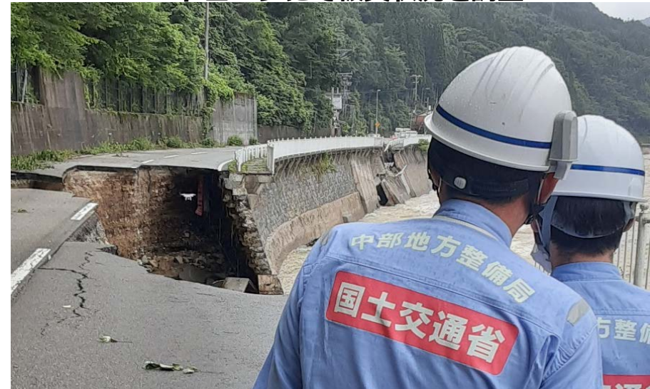
下呂市小坂町門坂の被災状況を調査②
