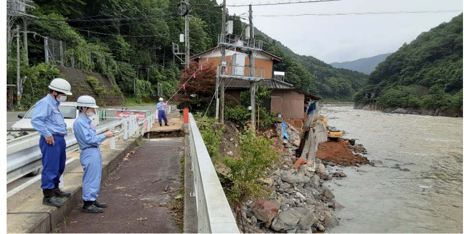
ドローンにて被災状況を調査
