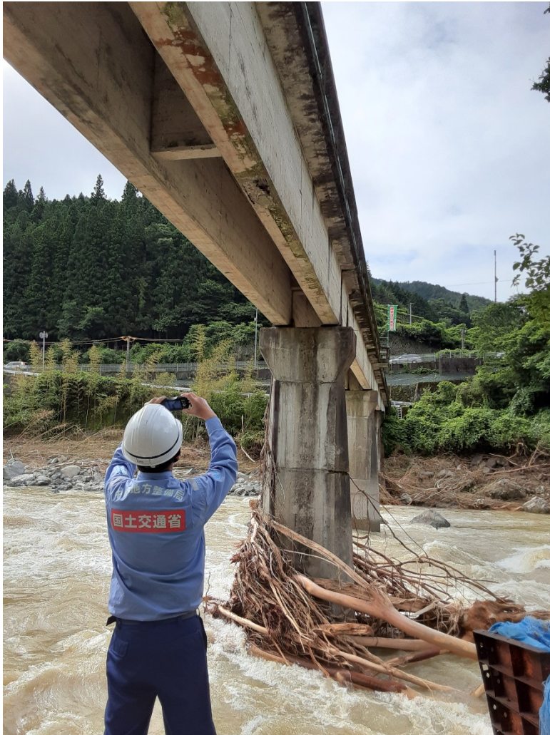
下呂市小坂町門坂の被災状況を調査①
