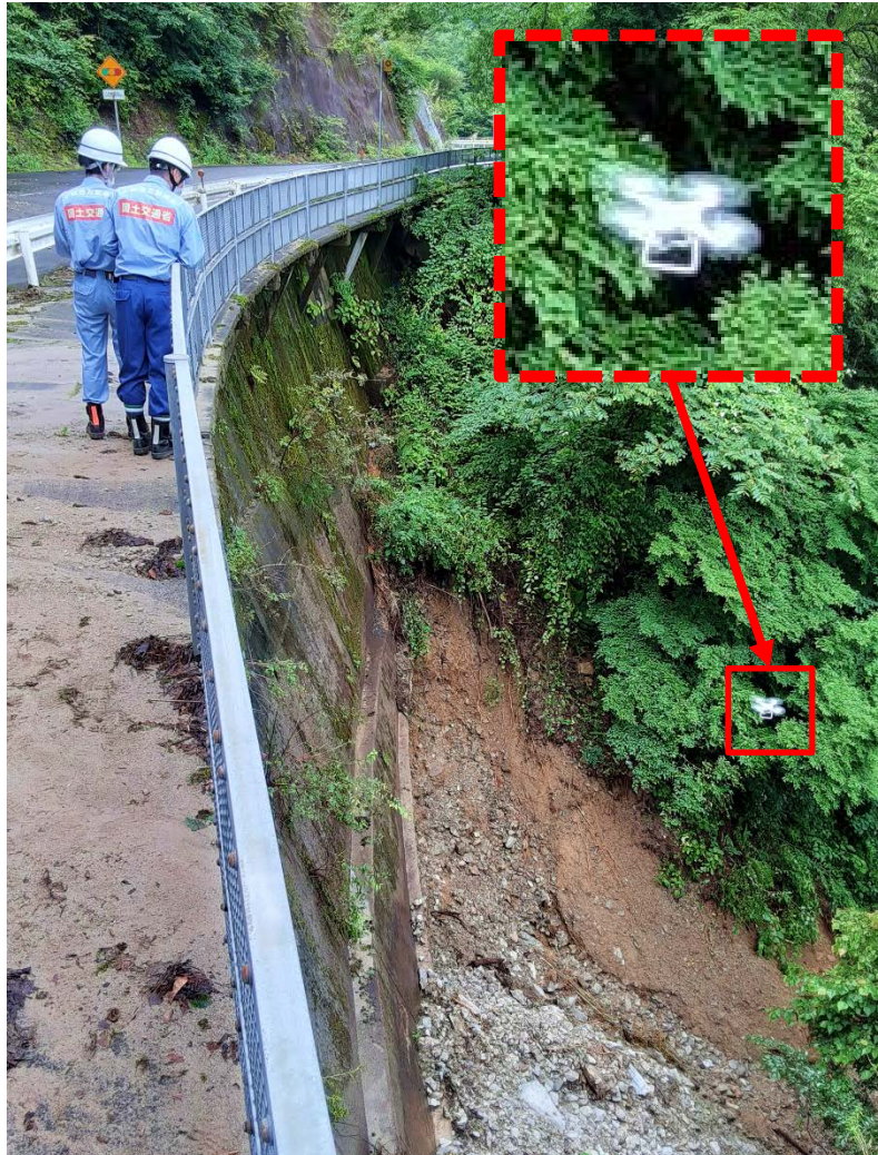
ドローンにて被災状況を調査①
