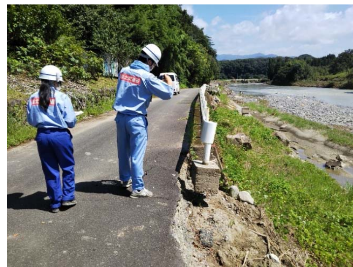
被災状況を調査(熊本県五木村)
