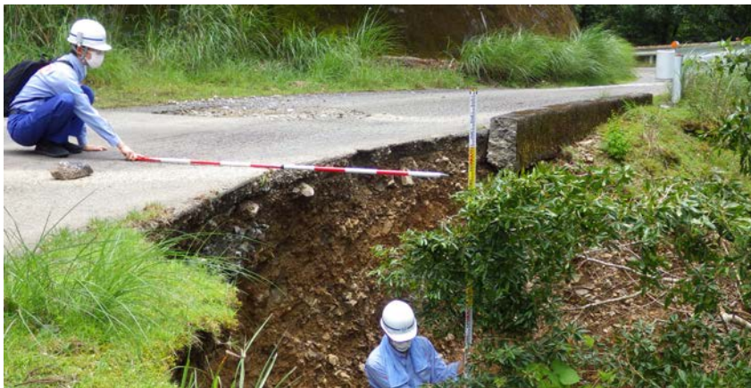
被災状況を調査③(熊本県五木村)
