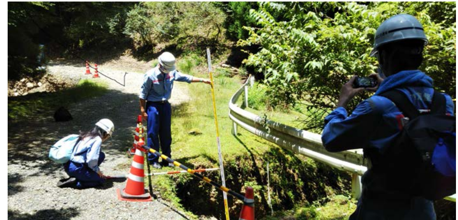
被災状況を調査②(熊本県五木村)
