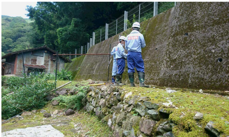
【五木村中村地区の被災状況確認①】
