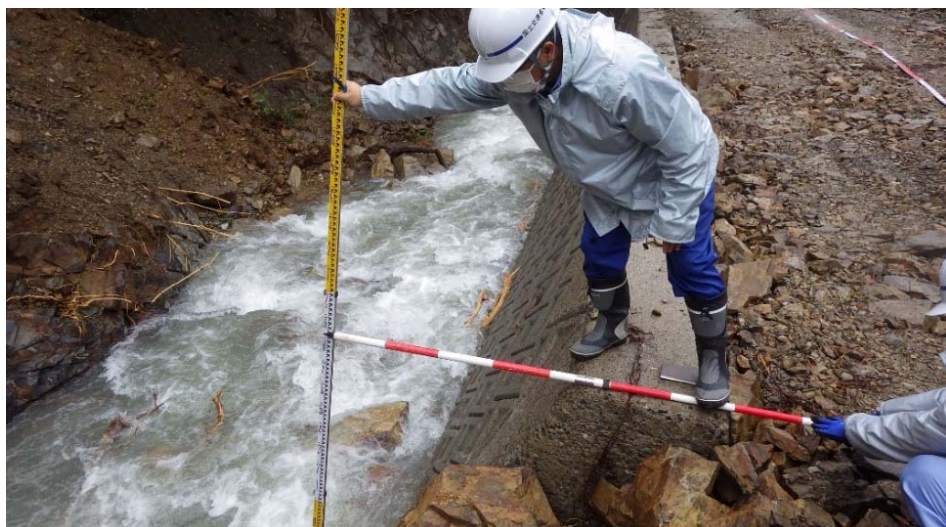
被災状況を調査（熊本県湯前町）
