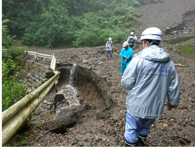
湯前町にて被災状況調査
