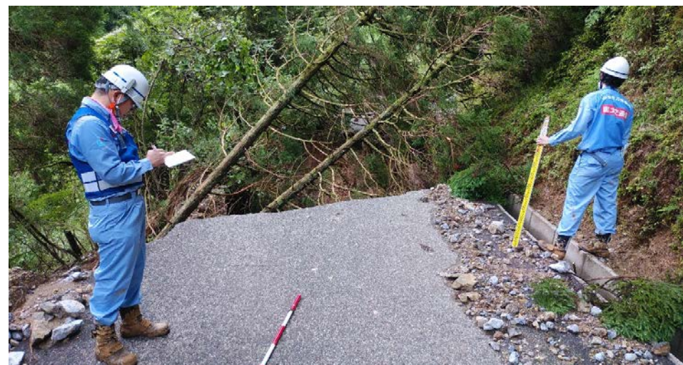
被災状況を調査（河川調査班）
