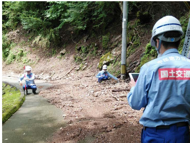
村道大通線 道路路肩崩落現場調査
