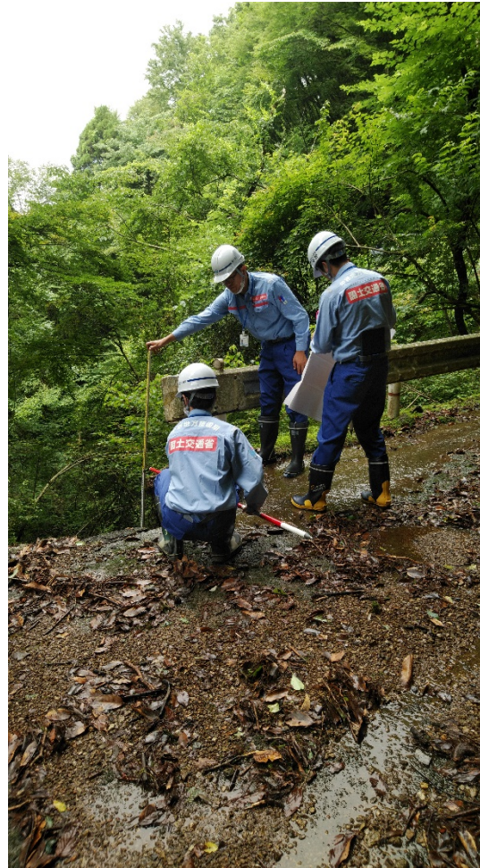
道路路肩崩落現場調査
